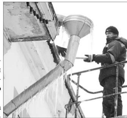
Нарушения устраняются незамедлительно.
