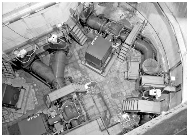
Насосная станция, поднимающая воду из Волги.
